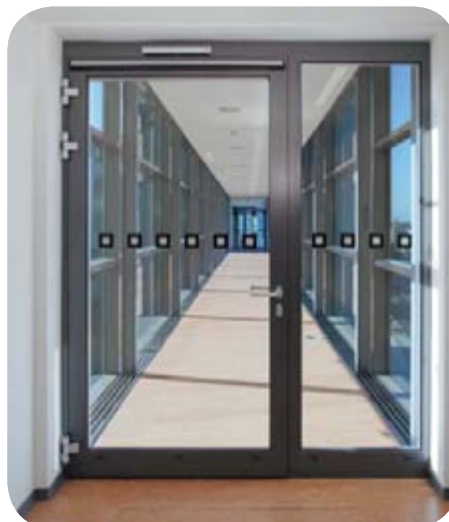
In den langen Rettungsfluren auf den Büroebenen unterstützen die automatisierten Feuerschutzabschlüsse die Gliederung in Brand- und Rauchabschnitte.
