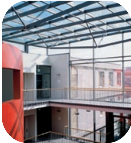
Die Dachkonstruktion der Glashalle Süd wurde aufgrund der zu berücksichtigenden Wind-, Schnee- und Betretungslasten in Stahlbauweise konzipiert.
