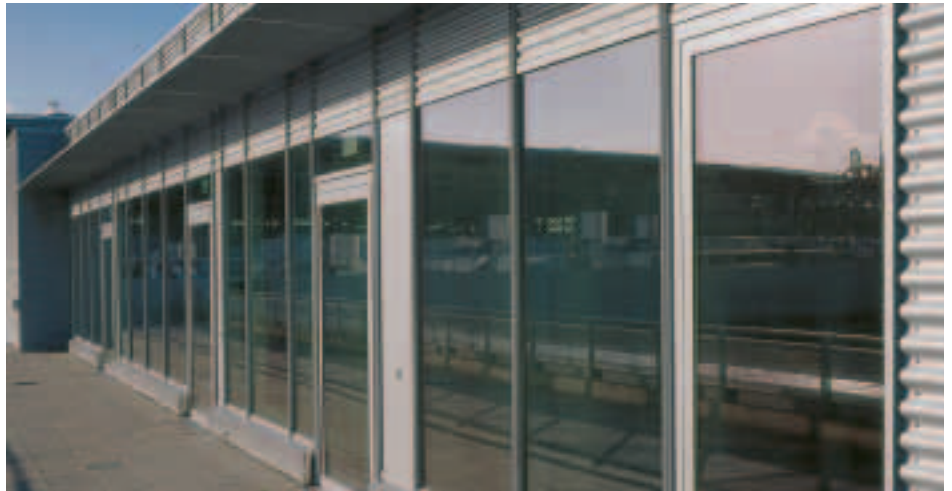
Brandschutzverglasungen im Dachbereich.
