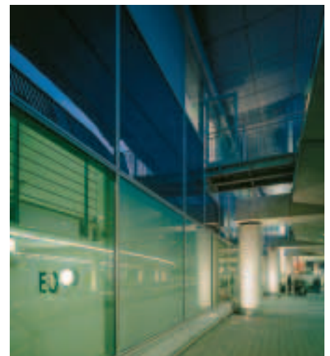
Einige Fluchtwege münden unterhalb der Vorfahrtplatte ins Freie. Natürlicher Lichteinfall ist durch Pilkington Pyrostop -Verglasungen gegeben, die teils mit Spezialfolien ausgestattet wurden.
