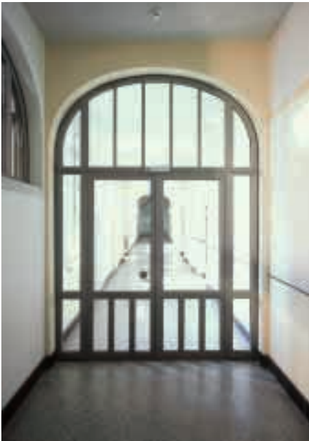
Die langen Flure des Gebäudes wurden mit F 30/T 30-Türanlagen brandschutztechnisch unterteilt und zum Fluchttreppenhaus hin abgesichert.
