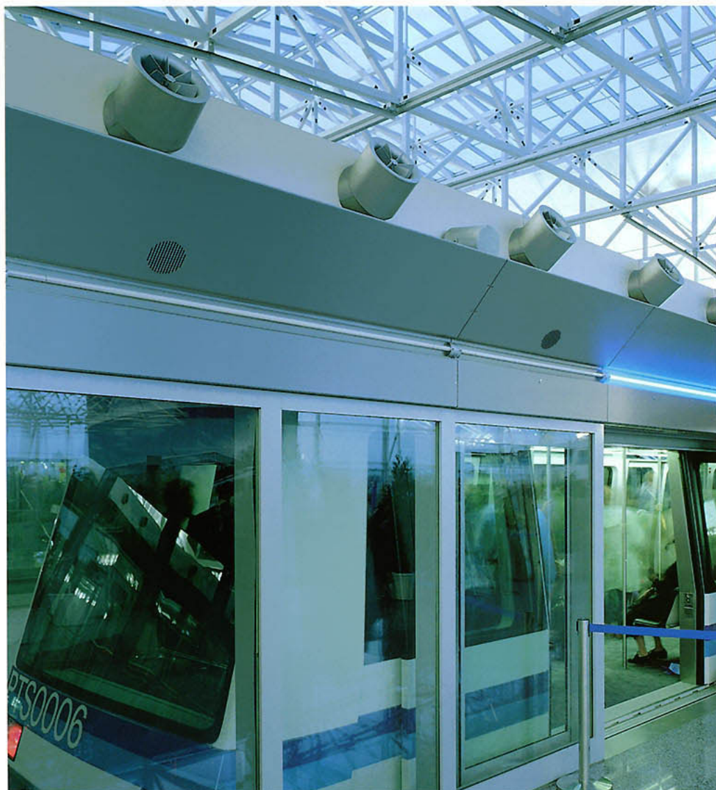
Glastunnel und Zugangstüren in F 30: Der Bahnhof erfüllt im Brandschutzkonzept zugleich die Aufgabe eines Evakuierungspunktes im Falle einer Zughavarie (System SCHÜCO / PYROSTOP).
