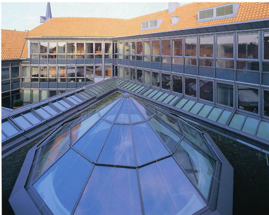
Situation 1: Das V-förmige Lichtband oberhalb der Schalterhalle ist aufgrund der Nähe zum Anbau als G 30 Konstruktion ausgeführt (PYRODUR / RP-Technik Mannesmann). Die eigentliche Glaskuppel hält den Mindestabstand von 5 m zum Anbau ein; hier genügt ein „normales“ Verbund-Sicherheitsglas.
