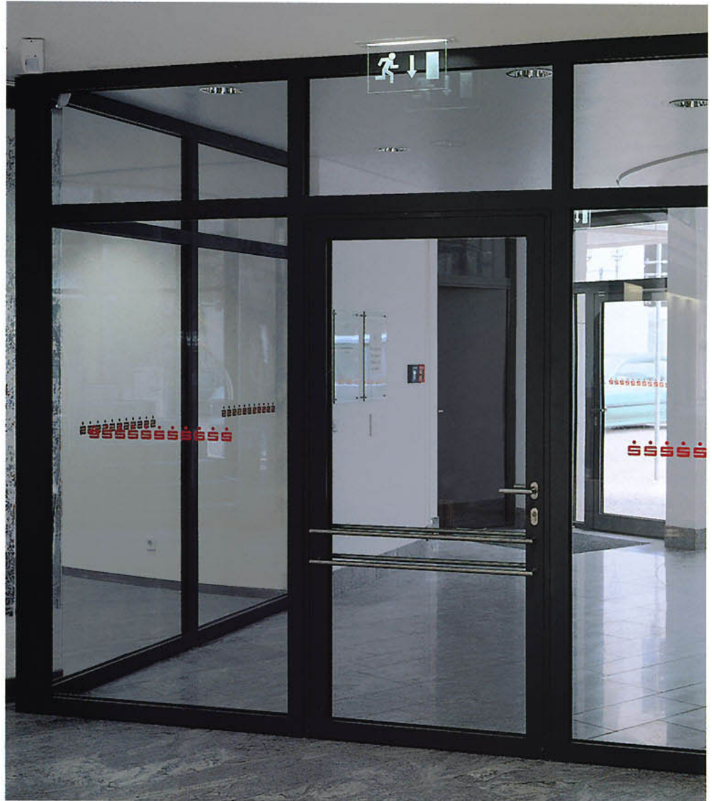
Situation 5: Die Zugänge zu den notwendigen Treppenträumen sind als T 30 Türkonstruktionen mit großen F 30 Oberlichtern und Seitenteilen ausgeführt (PYROSTOP® / MBB Glissa).
