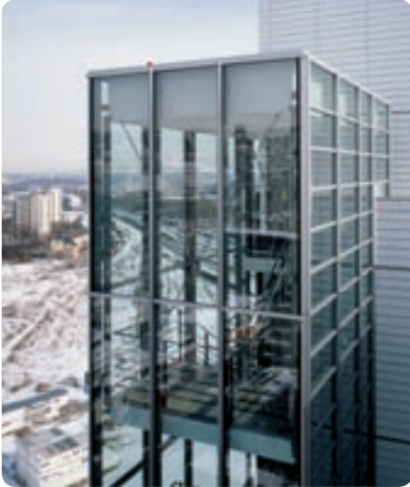
Im Inneneckbereich ist die F 30-Brandschutzfassade sichtbar (Pilkington Pyrostop ® / System stabilux F 30); sie wurde im 90°-Winkel zulassungskonform an die Stahlfassade angeschlossen.
