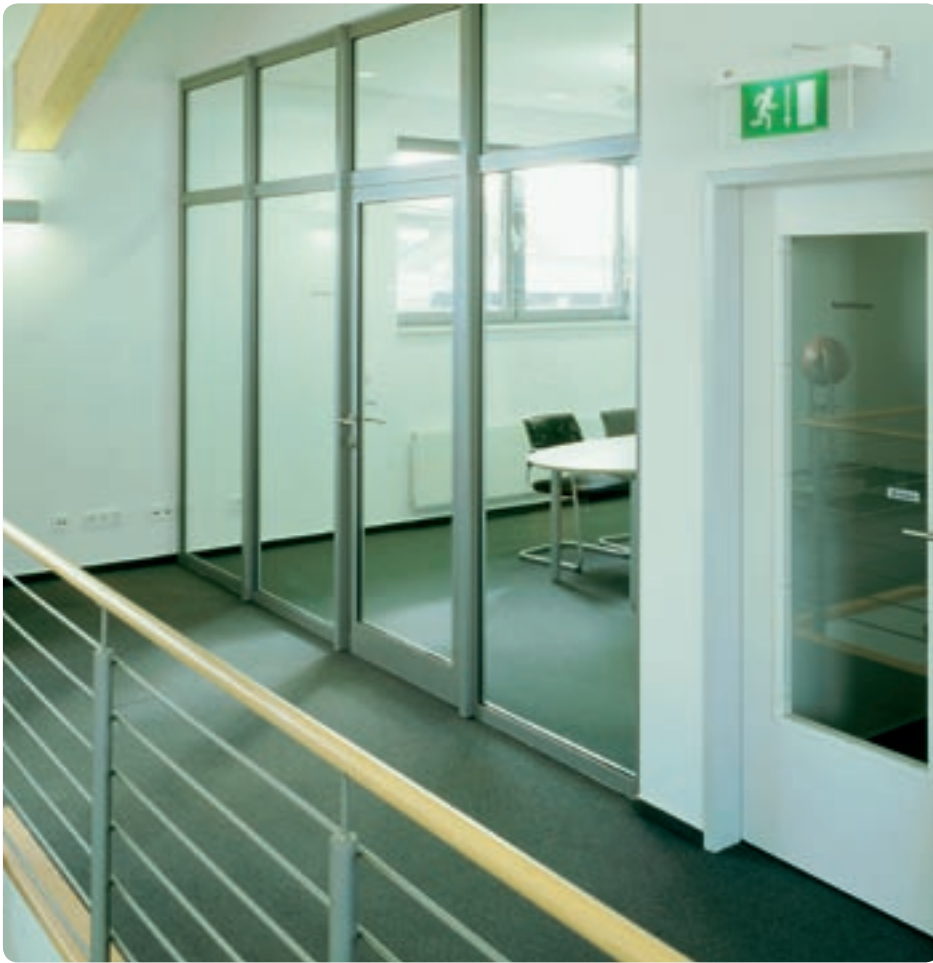
Transparente F 30/T 30-Abtrennung vom Besprechungsraum zum Fluchtweg im 1. Obergeschoss.
