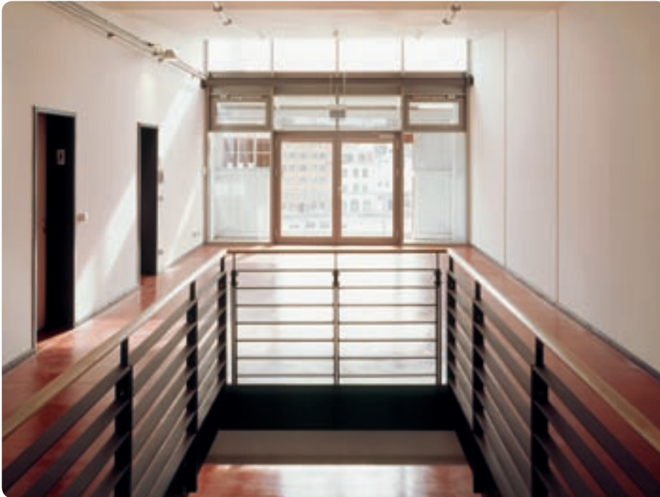
T 30-2-Türsysteme sichern die Fluchtwege und Treppenraumzugänge ab.
