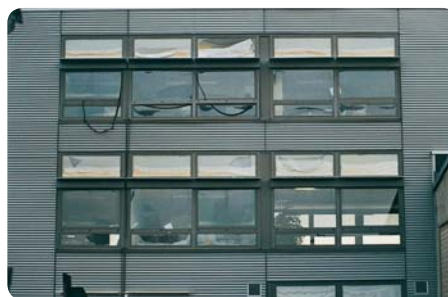
Geborstene Scheiben, herabhängende Dichtungen und brandbedingte Schäden in den angrenzenden Räumen: Folgen der Hitzestrahlung eines Brandes in einem gegenüber liegenden Gebäude im Abstand von ca. 15 m.
