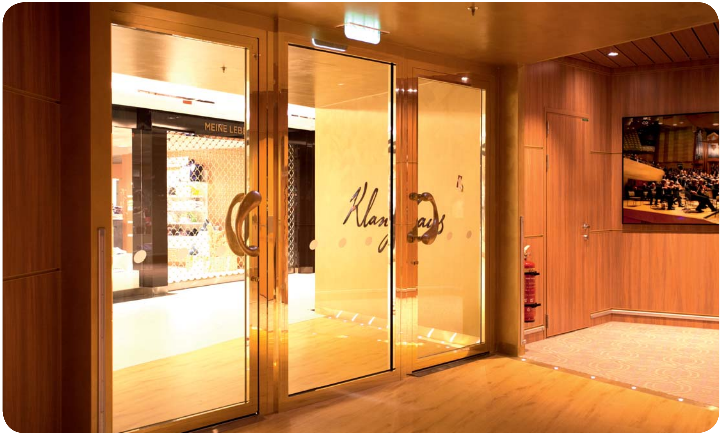
Verglaste Brandschutz-Trennwand mit zwei 1-flg. Türen der Brandschutzklasse B 15 (EI 15 / E 30) verglast mit Pilkington Pyrostop ® 30-10 zur transparenten Brandabschnittsbildung der einzelnen Nutzungsbereiche an Bord eines Kreuzfahrtschiffes. Bildquelle: Pocadel Oy (Finnland).
