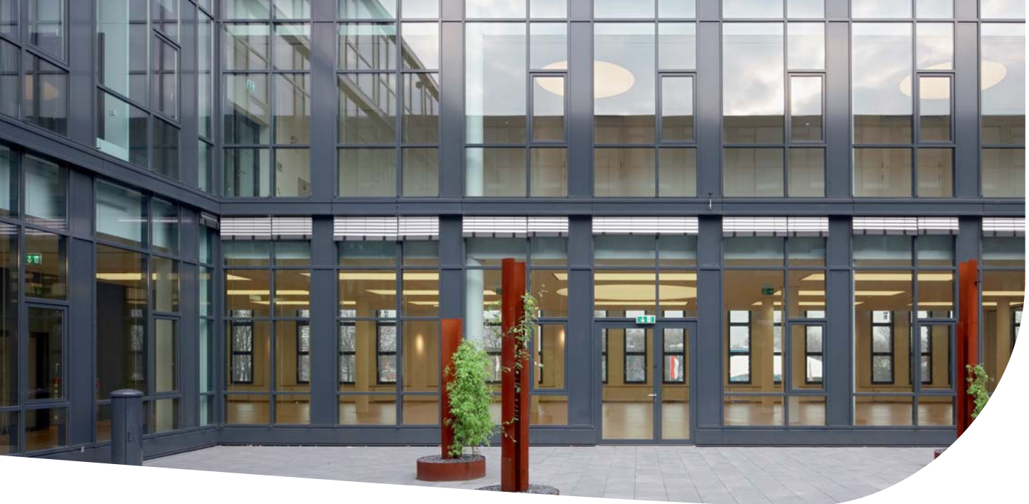
F (E1) 90-Fassade mit Pilkington Pyrostop® -Isolierglas zum Schutz vor horizontalem Feuerüberschlag in den Rheinhallen, Köln.
